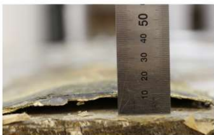
Détails avant restauration
